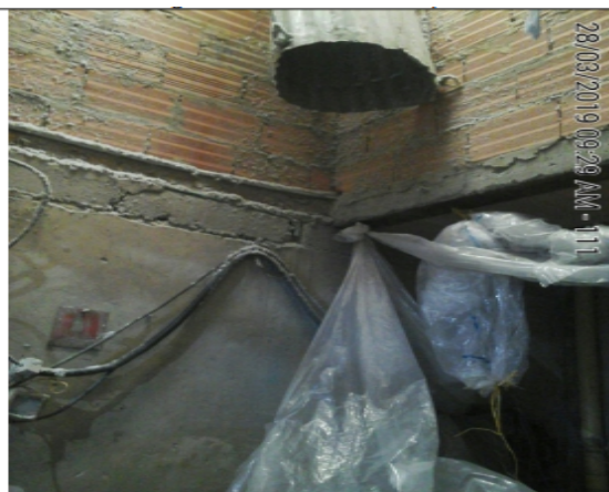
Fotografía N°. 3 Ducto.
